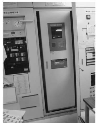
既存防災盤筐体
