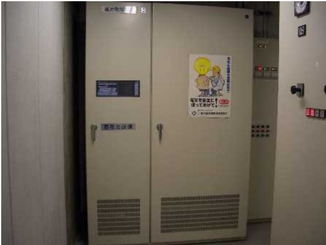
参考：直流電源装置、蓄電池写真
