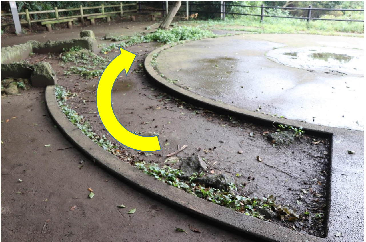
写真4 同上（土砂が流入した兵員待避所）
